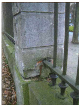
Abb. 44: Schadstelle an einem Pfeiler. (Foto: Veronika König)
