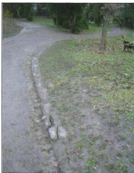
Abb. 54: Beschädigte Betonrinne. (Foto: Veronika König)
